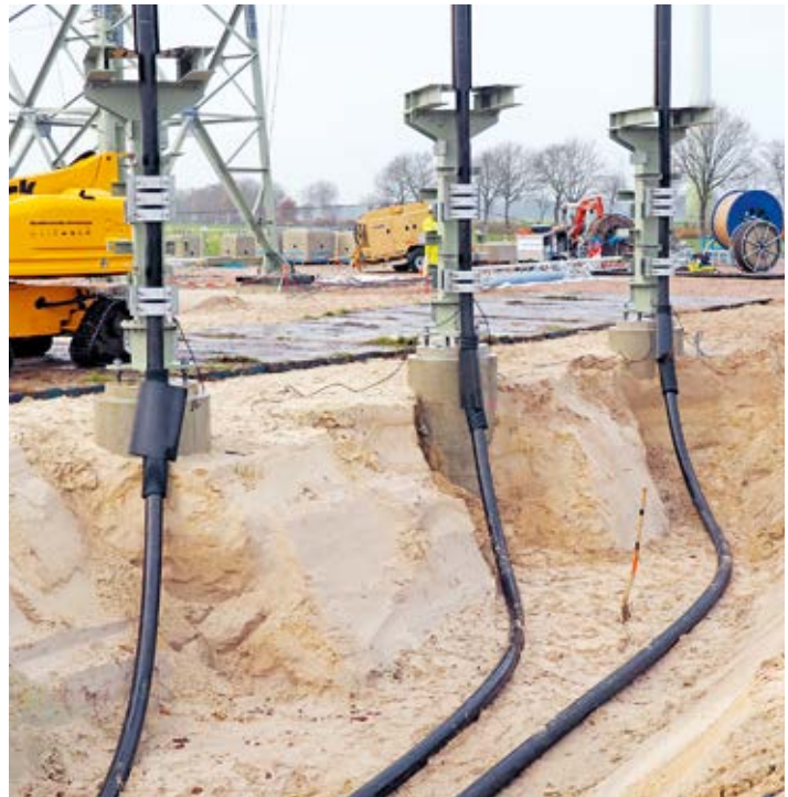
Freiluft-Endverschluss einer Umspannanlage in Deutschland.
